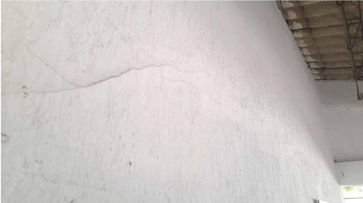
Ilustración 5- Grieta profunda, larga y ancha que fue tapada con procedimiento que no elimina ni reduce el riesgo, solo es un tratamiento visual - CLPEM - IPC
