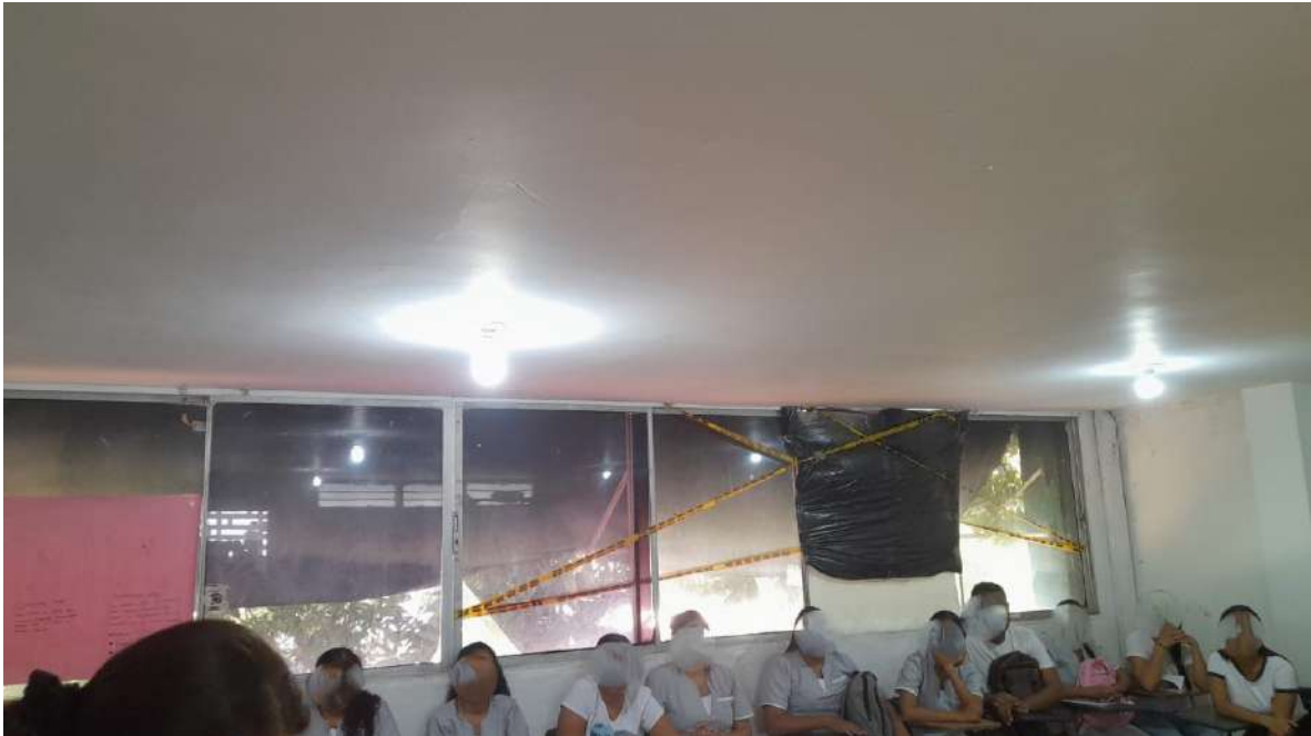
Ilustración 2-Vidrios con riesgo de caída sobre los aprendices - CAAG Fundación
