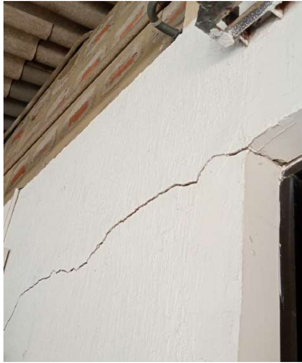
Ilustración 4- Presunto daño estructural - CLPEM - IPC
